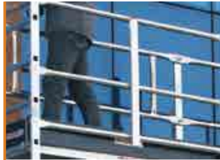
Verstärkung für Schutzgeländer. Renfort pour garde-fou.
